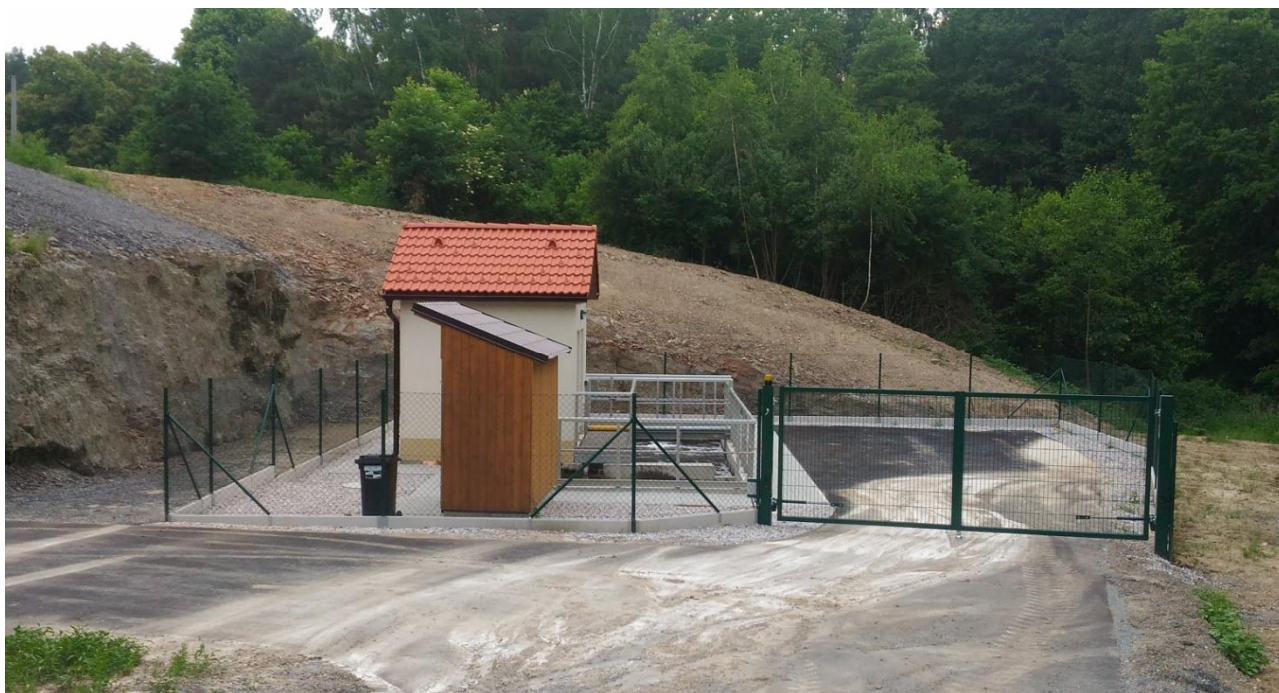
nově vybudovaná centrální ČOV Hlohová pro 350 EO
